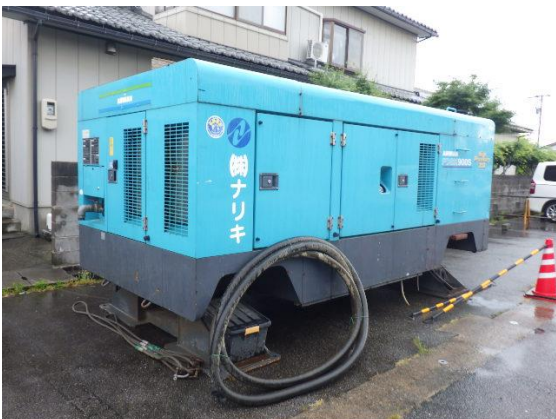
⑤大型コンプレッサー
